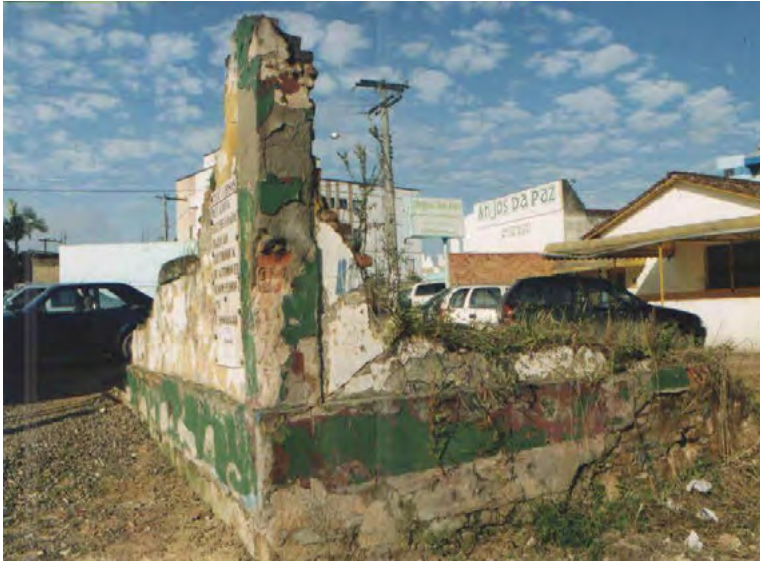
Figura 4 – Ruínas da Casa do Agente Ferroviário, em abril de 2001
